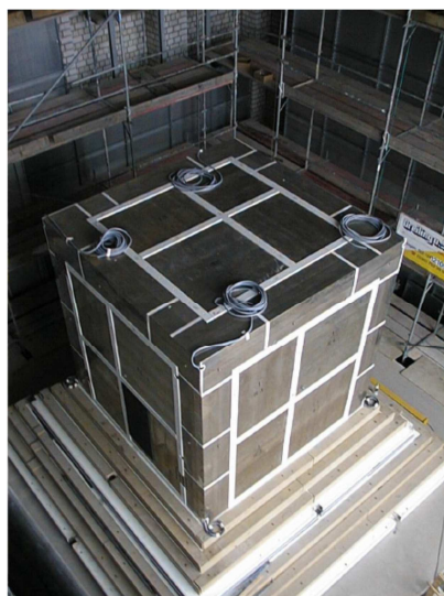
Figura 9 — Câmara blindada BMSR-2 durante sua fase de construção [50].
