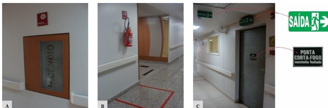
Figura 100 - Sinalização de regulação do Hospital Perinatal Barra: (A) placas dos hidrantes, (B) sinalização de piso e placa do extintor, (C) Placas das saídas e das portas corta-fogo
