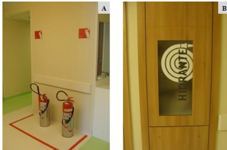
Figura 54 - Sinalização de piso e parede do Hospital Pro Criança Cardíaca: (A) para indicar os extintores, (B) para indicar o hidrante Fonte: A autora
