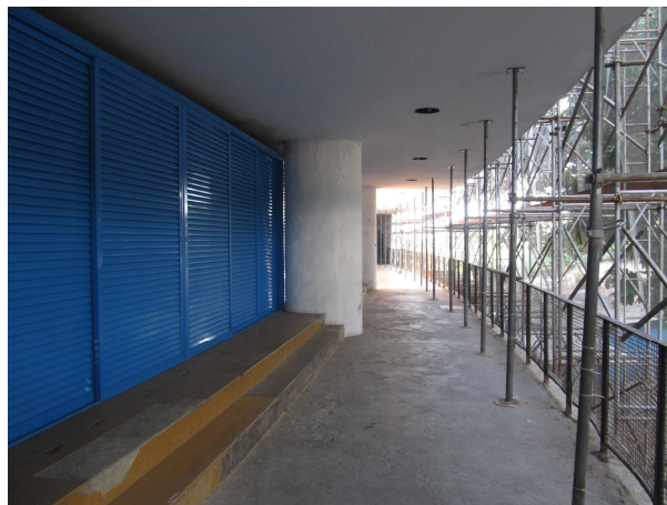
Imagem 34: Detalhe dos andaimes e da nova entrada da Associação de Moradores, no pavimento intermediário, que está sem piso.
