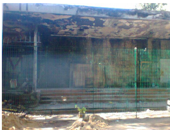
Imagem 41: Fachada danificada do antigo posto de saúde
