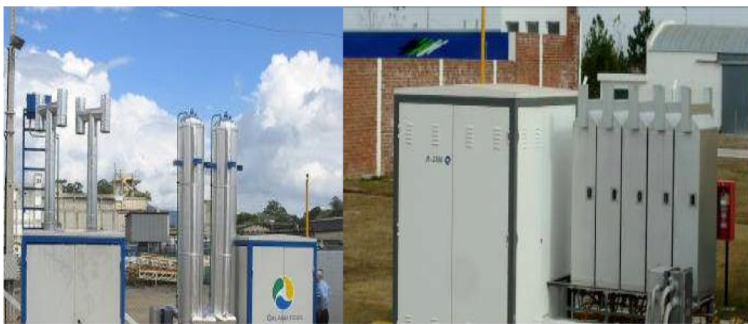
Figura 6.10: Estação redutora para sistema de gasoduto virtual de GNC. Fonte: Galileo (2015).
