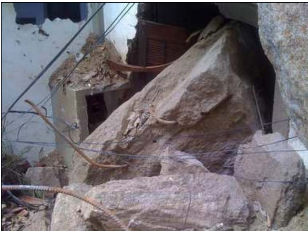
Figura 5.5. Blocos de rocha que atingiram as casas próximas ao talude. Pode se observar chumbadores nos blocos, estes blocos são oriundos da crista do talude (Geo-Rio, 2009).
