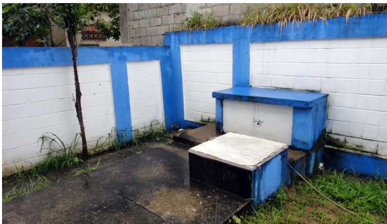
3.7.j.Caixa de força no canto esquerdo do pátio dos fundos (Fonte: Banco de imagens grupo INFOC)
