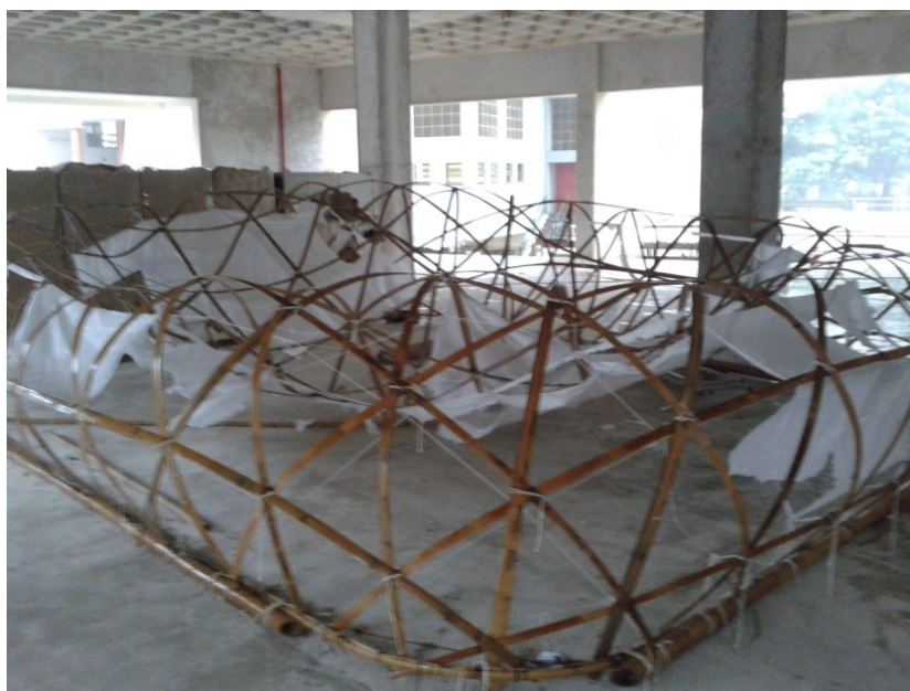
Figura 102: Estrutura deformada pela ação da chuva e do vento.
