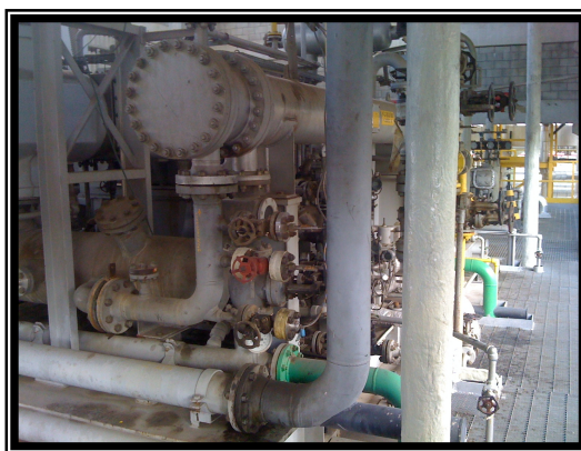
Figura 3-8 – Cilindros de compressão e tubulações
