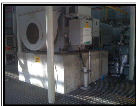
Figura 3-11 – Motor elétrico sobre uma das lajes de suporte
