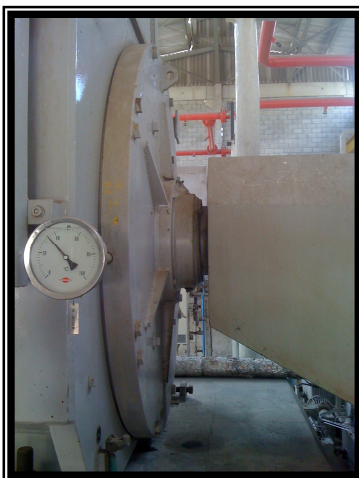
Figura 3-6 – Acoplamento entre compressor e motor elétrico
