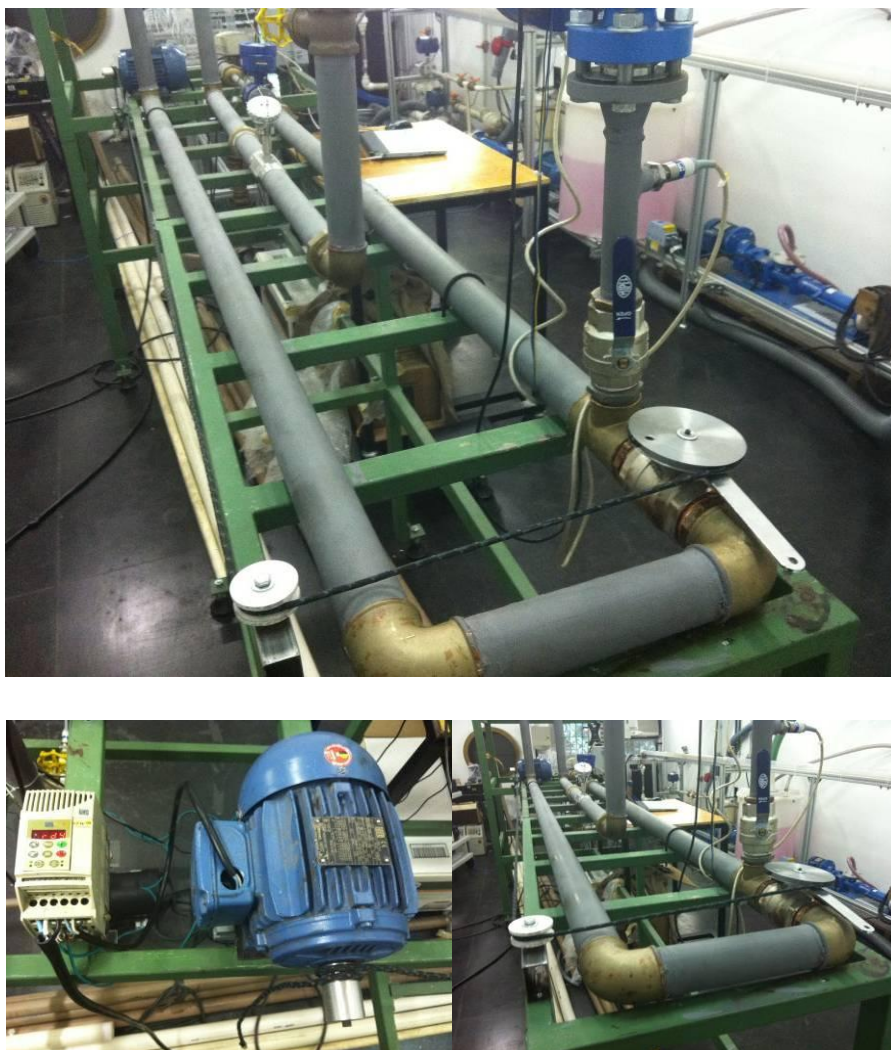
Figura 5.24 – Sistema de fechamento da válvula de bloqueio.
