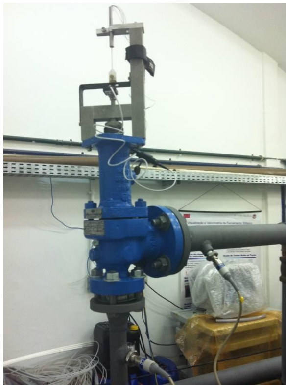
Figura 5.10 – Válvula de alívio montada no circuito de testes.
