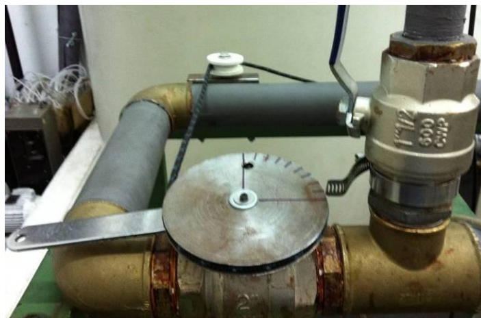
Figura 5.23 – Válvula de bloqueio utilizada para produzir os transientes hidráulicos na seção de testes.
