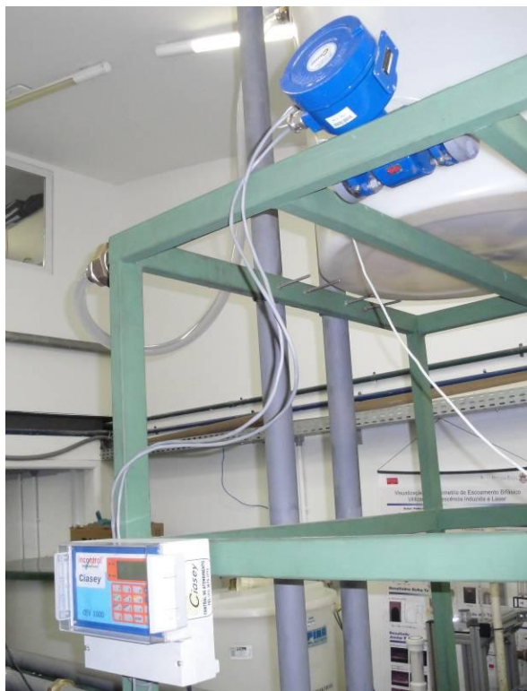
Figura 5.7 – Medidor de Vazão do Circuito Fechado.
