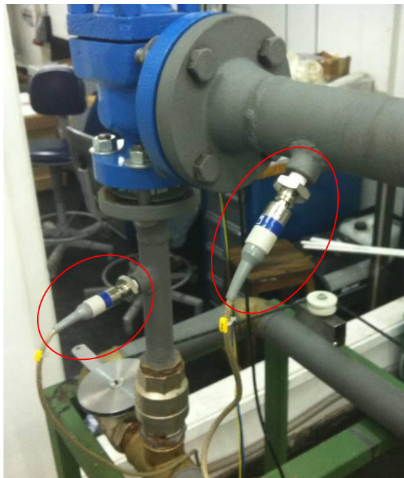
Figura 5.18 – Transdutores de pressão instalados a montante e jusante da válvula de alívio.
