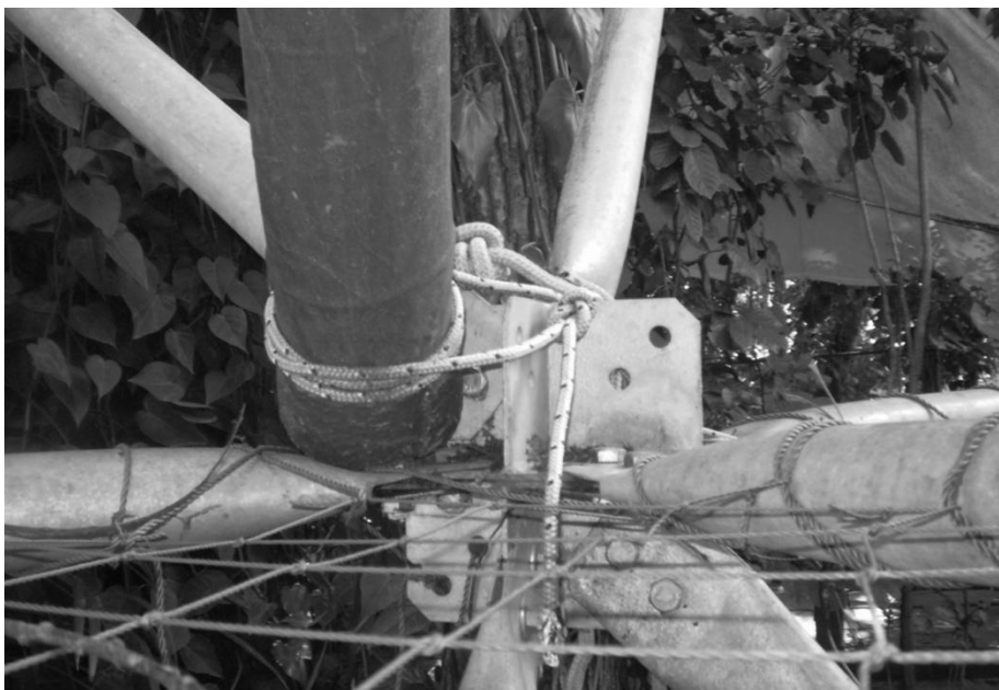
Figura 43 – Detalhe da base do bambu que estrutura a atual cobertura do laboratório, apoiado na junta da estrutura tubular.
