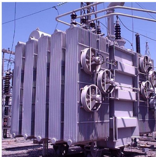
Figura 2 – Transformador de Potência (Benedet, 2008)
