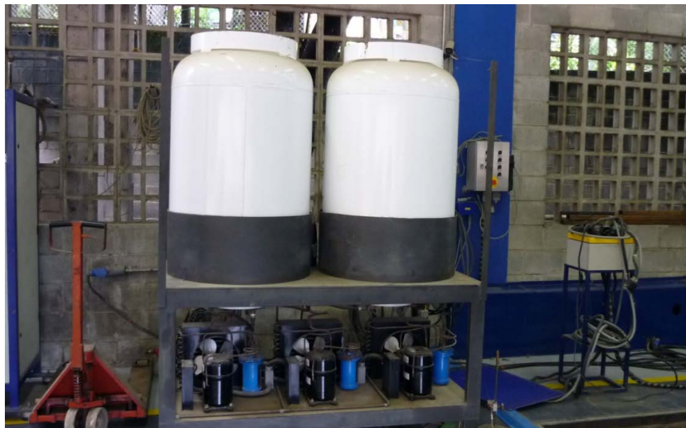
Figura 17: Sistema de compressão do gás natural
