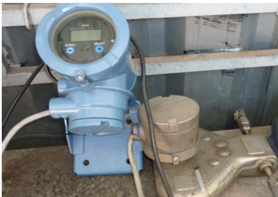
Figura 6: Medidor de vazão de Óleo Diesel.
