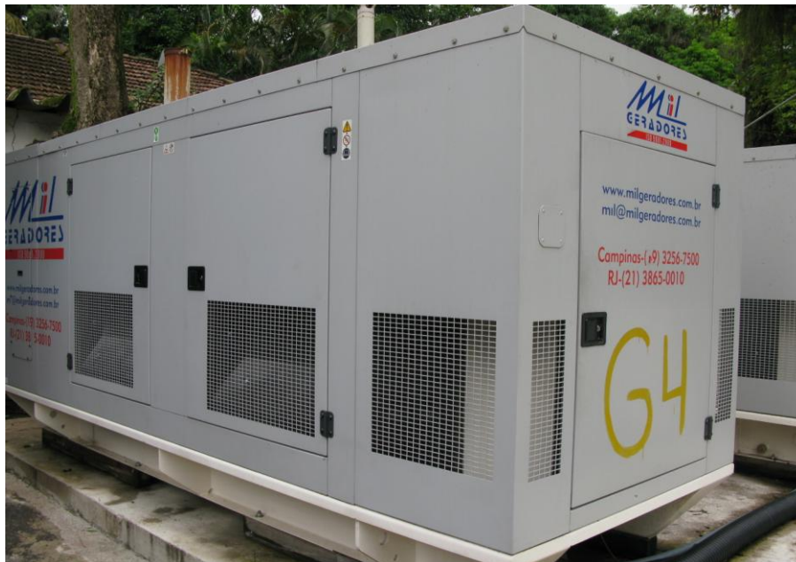
Figura 5. - Gerador de 400 kW FG Wilson S500E1 Instalado na PUC - Rio
