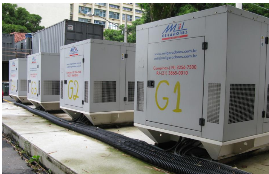
Figura 6. - Grupo de 4 Geradores de 400 kW FG Wilson S500E1 Instalados na PUC – Rio
