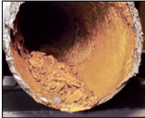
Figura 1 - Corrosão interna generalizada
