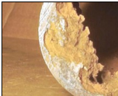
Figura 4 - Corrosão alveolar sob depósito
