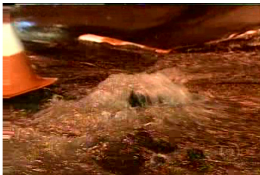
Figura 11 - Tubulação rompida: enquadramento 1
