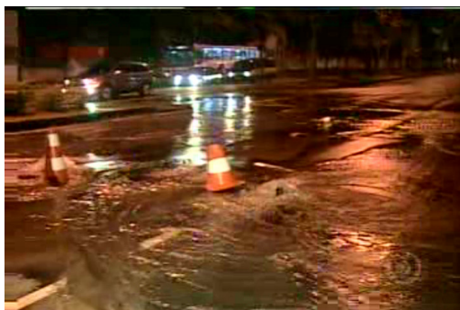
Figura 12 - Tubulação rompida: enquadramento 2
