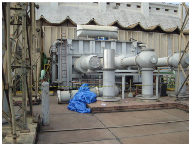
Figura 22 – Transformador 58599 – Caso de Estudo
