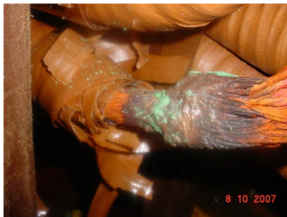
Figura 45 – Sinais de aquecimento no cabo de interligação da bobina de H1
