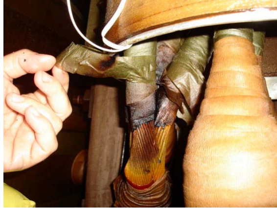
Figura 43 – Queima da camada externa do papel isolante do comutador H1
