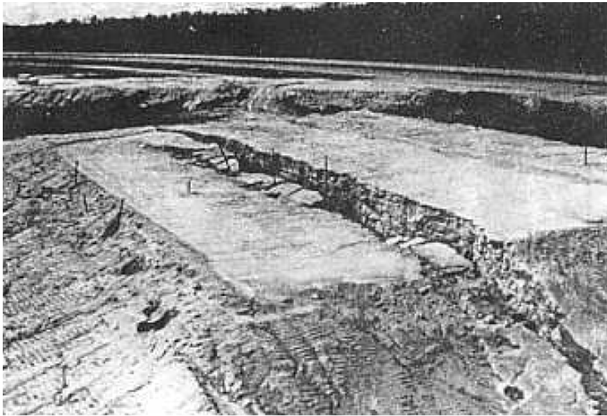
Figura 7.3 – Ruptura do aterro após 100 dias de construção.
