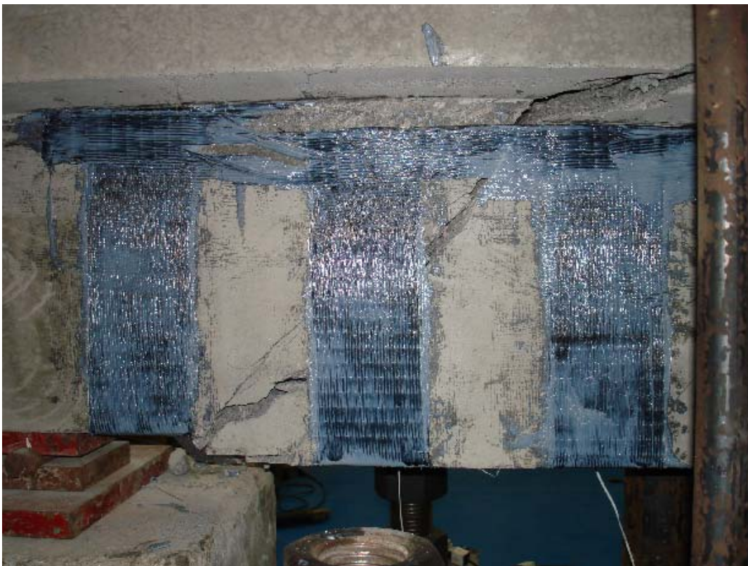
Foto A.28 – Detalhe da ruptura da viga VI-3 (2).
