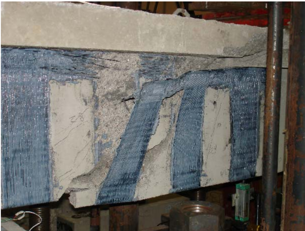
Foto A.26 – Detalhe da ruptura da viga VI-2 (2).
