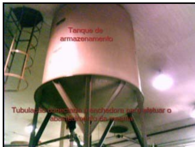
Figura 4 – Tanque de armazenamento
