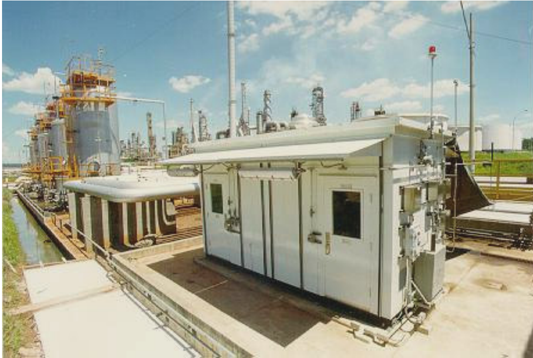
Figura 5.2: Analyzer Shelter (visão externa) - REPLAN.
