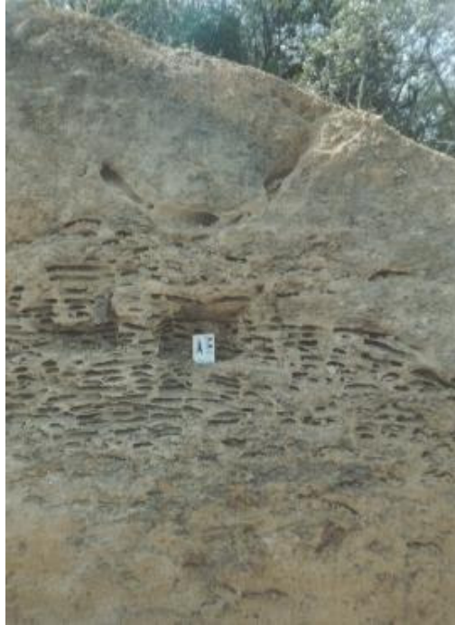
Figura 96 - Área do cupinzeiro identificada no talude 02 (vista lateral do talude).
