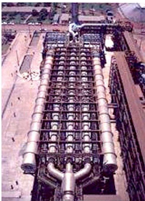
Figura 29 – Vista de cima de um reformador utilizado pela tecnologia Midrex para produção de ferro-esponja.
