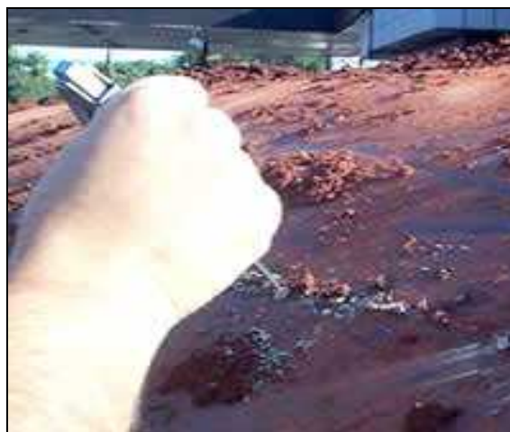
Figura 2.3-Detalhe de corrosão em tanque metálico (CETESB, 2003).
