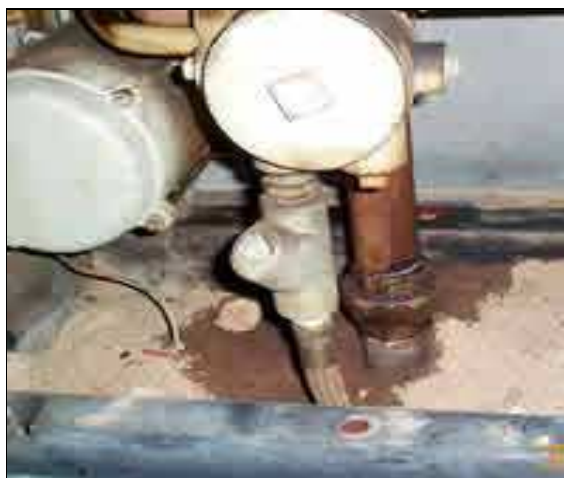
Figura 2.2-Vazamentos de gasolina na bomba de abastecimento (CETESB, 2003).
