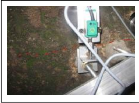
Figura 7.18 – Trinca gerada no momento da pressurização do furo PUC-2.
