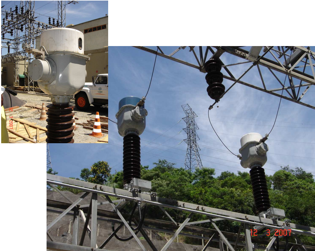
Figura 29: Transformadores de corrente
