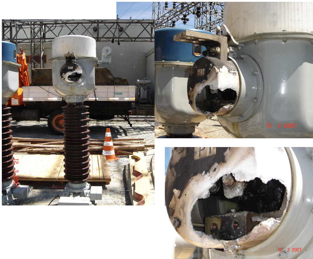
Figura 30 - Transformador de corrente danificado pela alta temperatura
