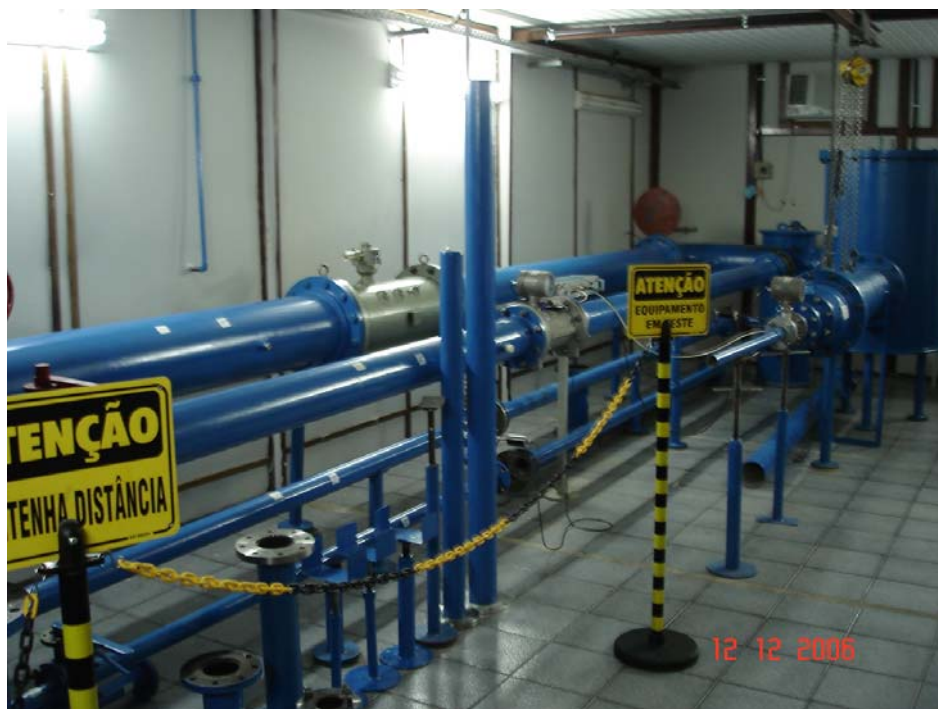
Figura 8: Bancada de Calibração de Turbinas
