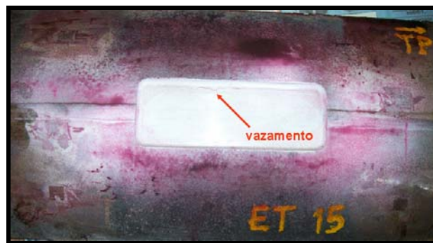
Figura 5-14 – Foto do local de vazamento do ET 15 na borda do defeito
