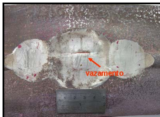
Figura 5-15 – Foto do ET 11 mostrando o local do vazamento entre a solda e o metal base
