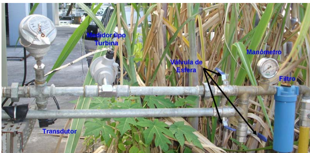
Figura 13 - Linha de alimentação de Gás Natural da planta de cogeração instalada na PUC-Rio.
