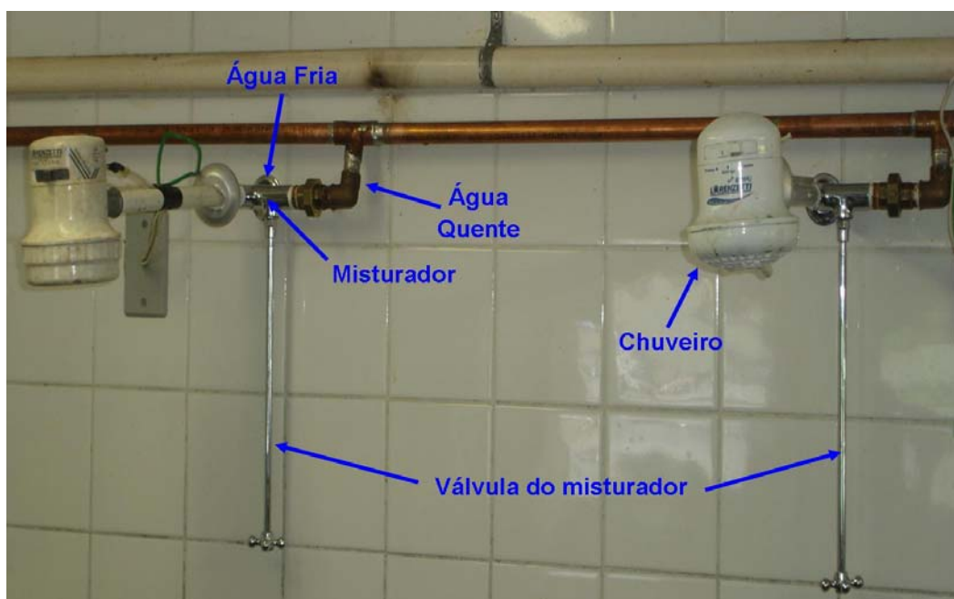
Figura 33 - Misturadores de água quente nos banheiros do ginásio da PUC-Rio.
