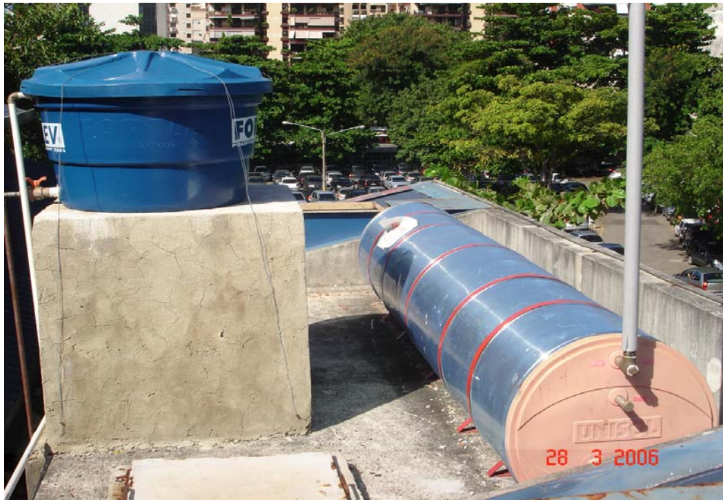
Figura 32 - Boiler e Caixa de Água da planta de cogeração da PUC-Rio.
