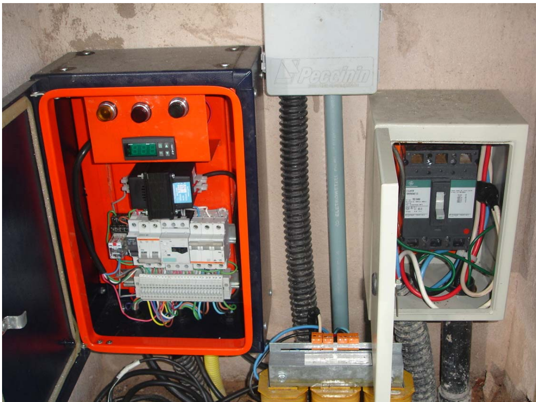
Figura 21 - Sistema de acionamento e proteção da microturbina Capstone C30 LPNG na entrada da rede elétrica da PUC-Rio.
