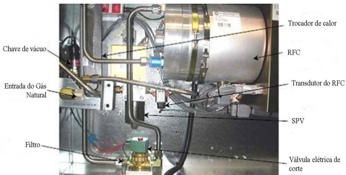
Figura 15 - Sistema de combustível da microturbina Capstone C30 LPNG (a).
