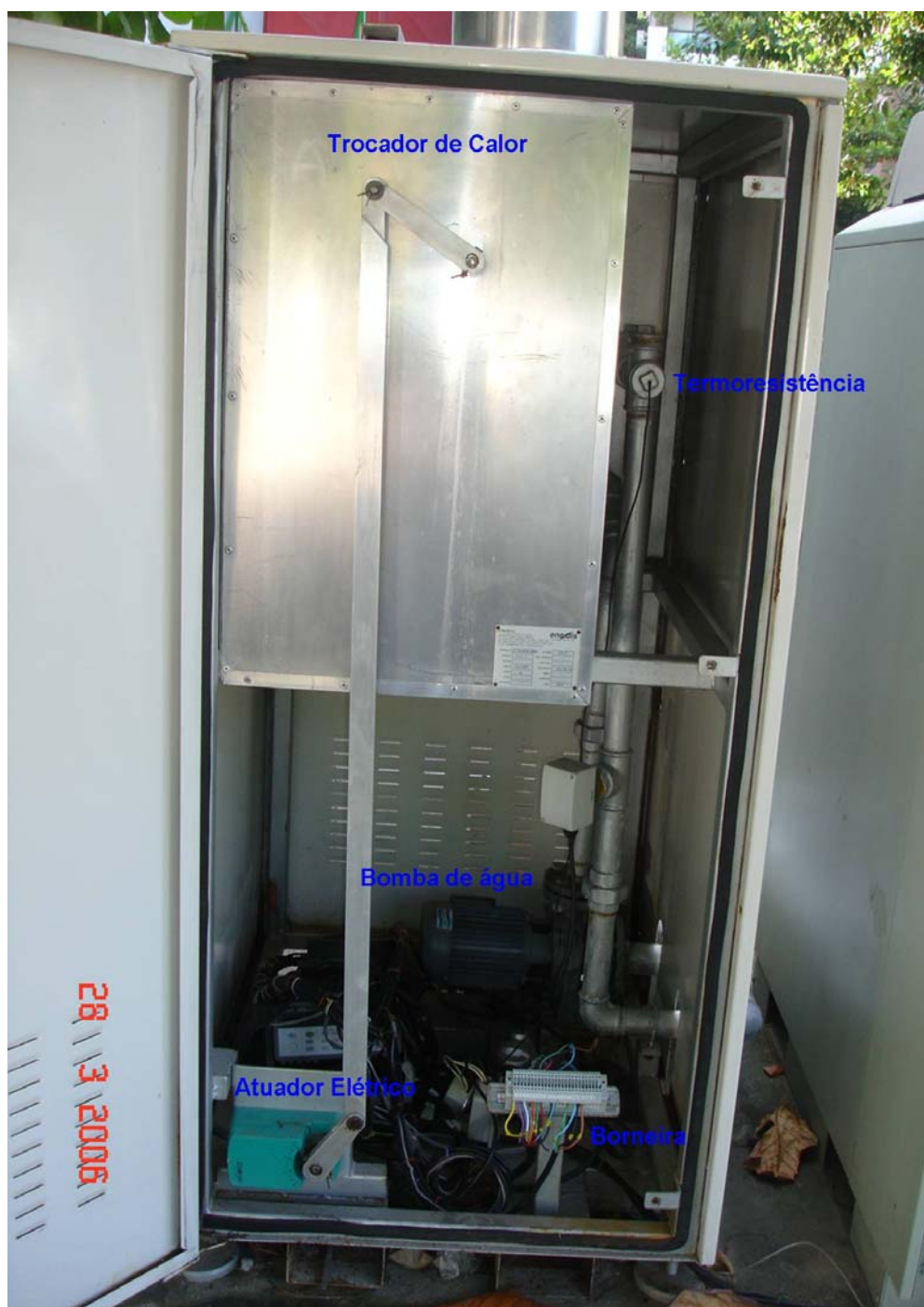
Figura 29 - Detalhe da Caldeira de Recuperação ITC1 da planta de cogeração instalada na PUC-Rio.
