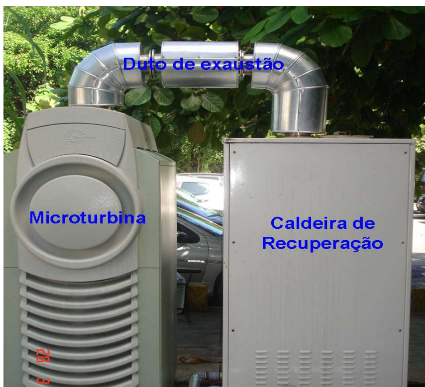
Figura 28 - Instalação do Duto de Exaustão entre a Microturbina Capstone C30 LPNG e a Caldeira de Recuperação ITC1.
