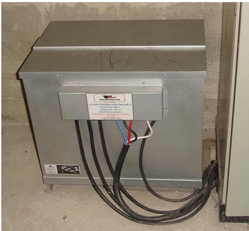
Figura 26 - Autotransformador Trifásico de 45 kVA instalado na PUC-Rio.
