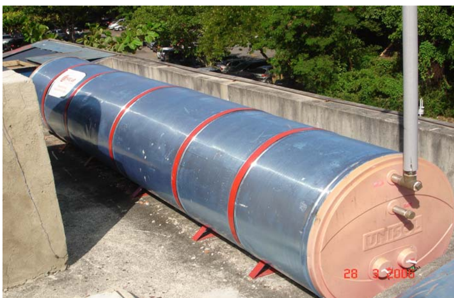
Figura 31 - Reservatório Térmico (Boiler) da planta de cogeração da PUC-Rio.
