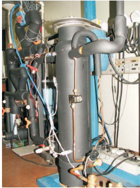
Figura 3.4: Fotografia do gerador de pasta de gelo.
