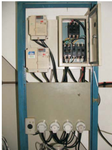
Figura 3.9: Fotografia do painel elétrico.
