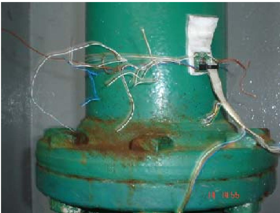
Figura 33 – Detalhe da montagem do acelerômetro na Usina Fontes Nova, após uma válvula.
