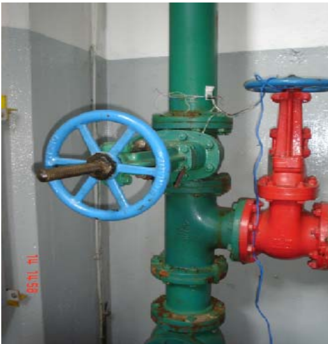
Figura 32 – Montagem do acelerômetro na Usina Fontes Nova, após uma válvula.
