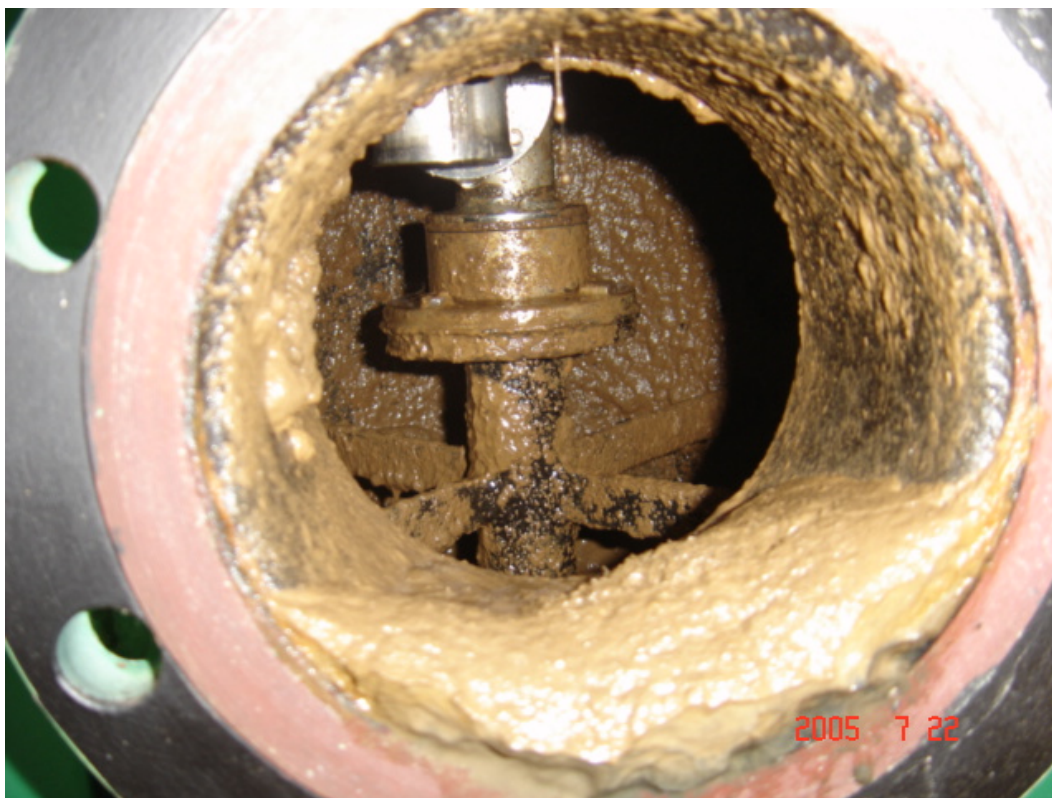
Figura 2 – Medidor de Vazão Tipo Turbina - Desmontado para Manutenção.
