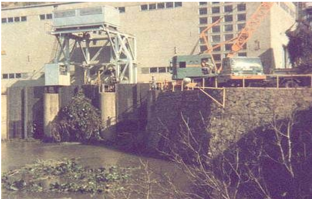
Figura 1 – Máquina Limpa Grades retirando algas da Tomada d'Água da Usina de Fontes Nova.
