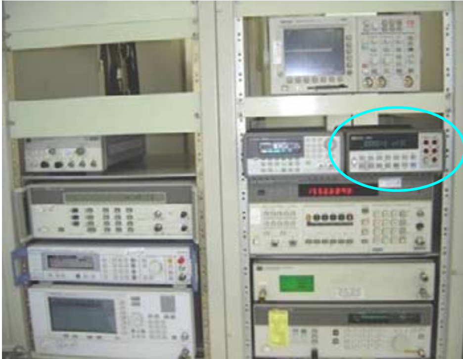
Fig. 5 – Console de Grandezas Elétricas do PAME-RJ
