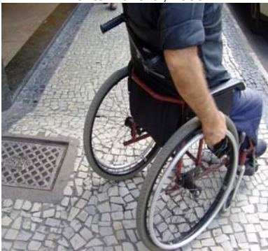
Figura 83 – Desnível lateral da calçada acentuado
