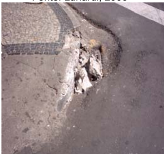
Figura 72 – Bueiros mal conservados
