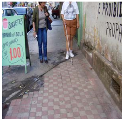
Figura 65 - * Placa obstruindo a passagem
