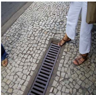
Figura 85 – Mal conservadas das grelhas
