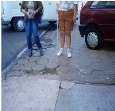
Figura 62 - * Piso irregular e mal conservado
