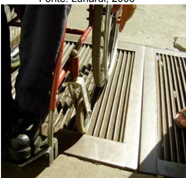
Figura 87 – Grelhas de captação de água A roda da cadeira prende-se e parte
