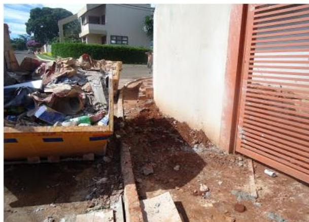
Figura 17 – Calçada sem possibilidade de circulação, com a obra não sinalizada, não possuindo uma rampa provisória para desvio pelo asfalto. Fonte: Blog Acessibilidadenaprática. (2011)
