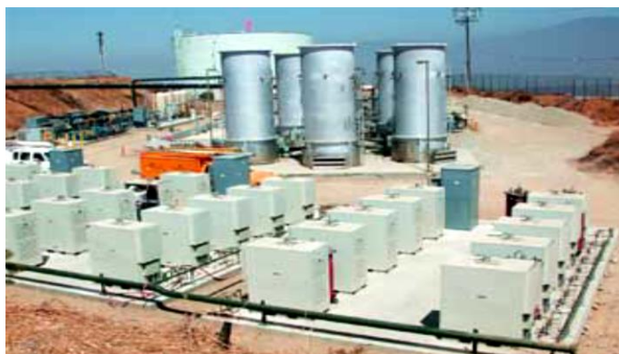
Figura 54 – Instalações com microturbinas em aterros. Fonte: Godlove, 2010.
